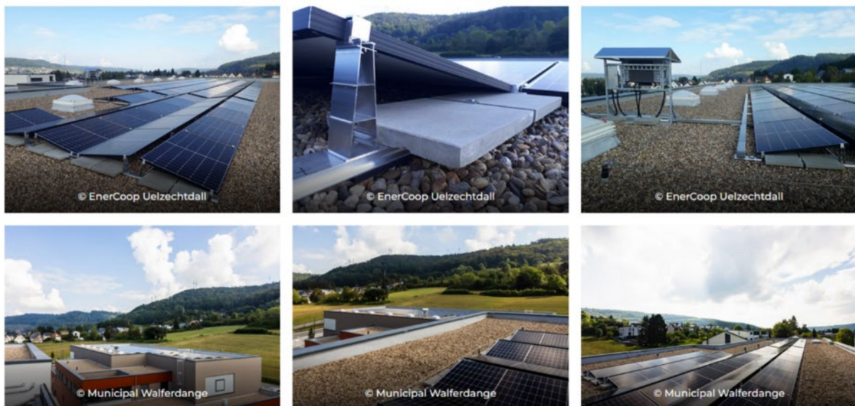
Figure 5 : Impressions de l'installation photovoltaïque Helmsange Maison-Relais et salle de sport.
