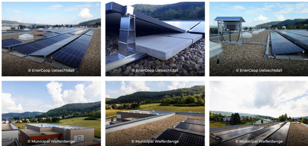
Abbildung 5: Eindrücke der Photovoltaikanlage Helmsange Maison-Relais und Sporthalle.
